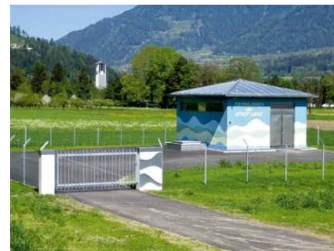
Der neue Tiefbrunnen wurde 2006 südlich des Dolomitenbades errichtet.
