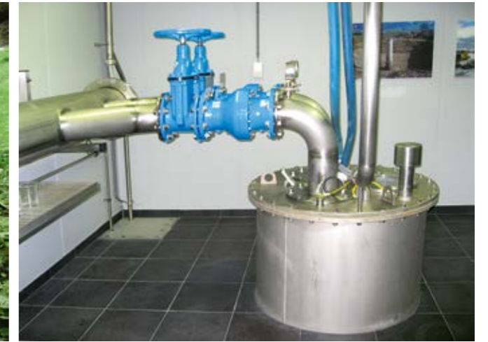
Der Brunnenkopf des Tiefbrunnens.
