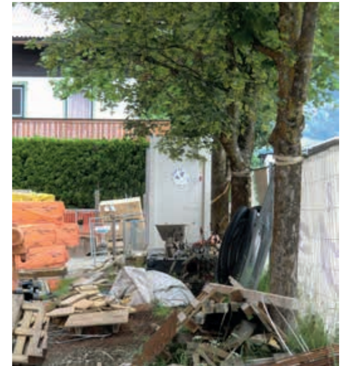
KEIN Baumschutz auf dieser Baustelle - Vitalitätsminderung und Faulstellen in den Folgejahren sind zu erwarten
