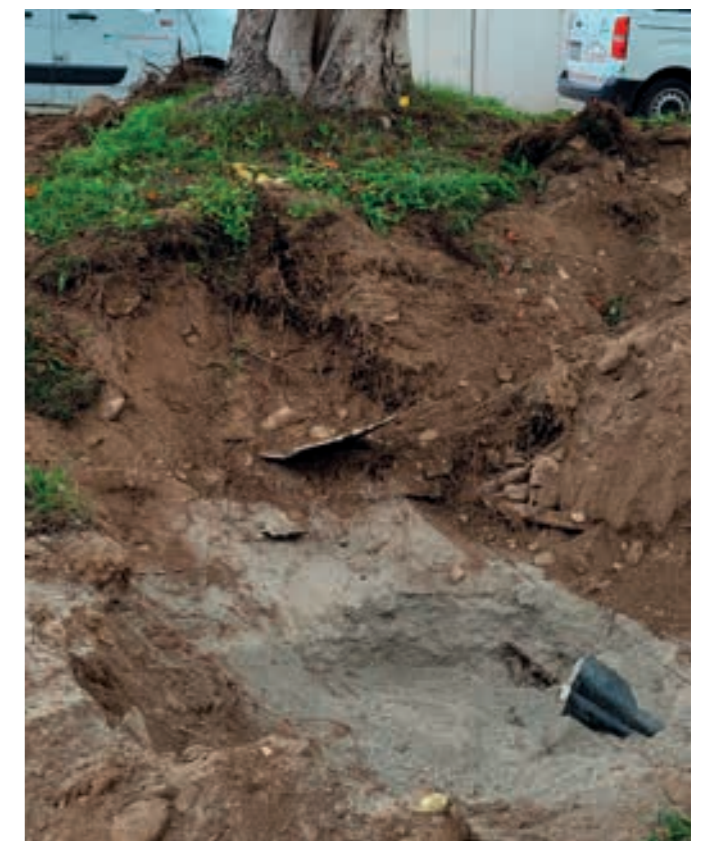
Leitungsgrabung in Grünflächen schädigt Boden und Baumwurzeln (Moarfeldweg)
